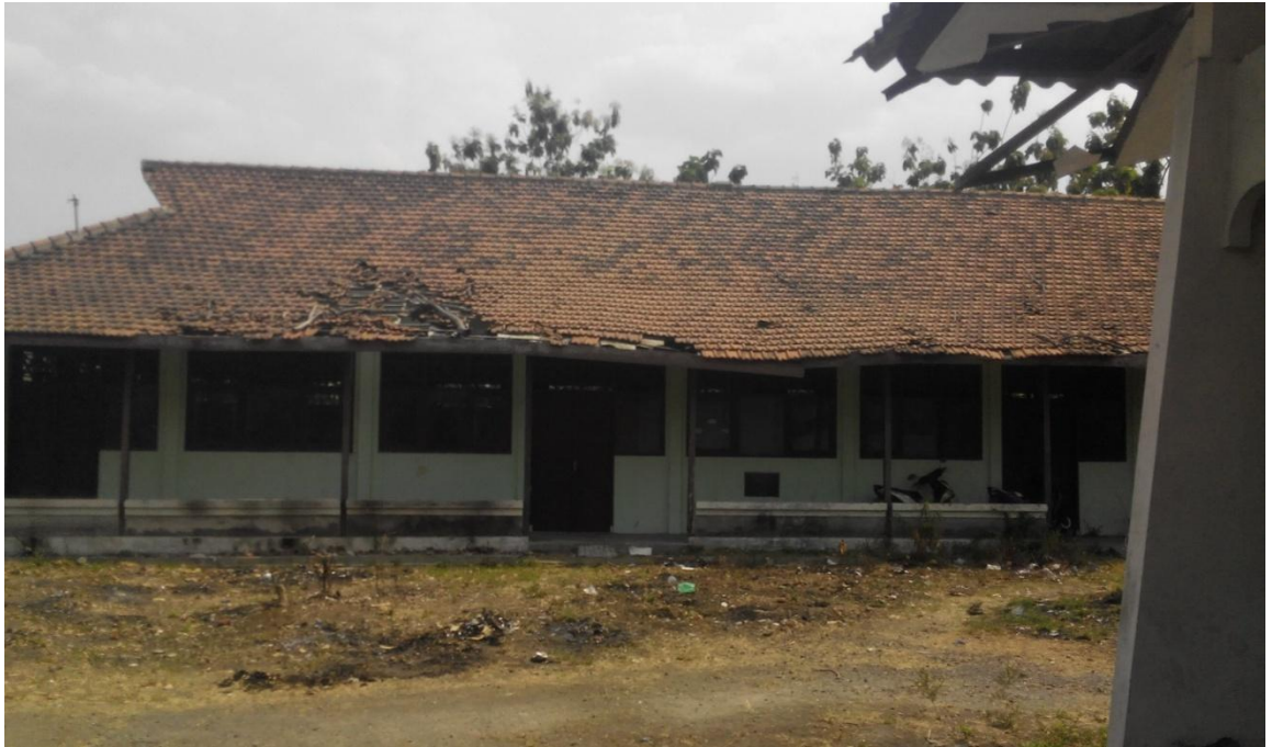
Gedung LPTQ di samping Wisma Sejahtera BKM yang kondisinya
