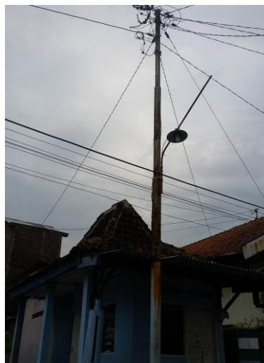
Sumber : Dokumen pribadi Gambar 1.11 Tiang listrik
