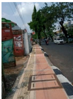
Gambar 10 Trotoar tidak rata di Jl. Pramuka
