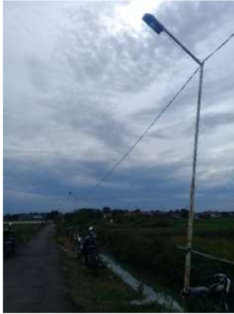
Gambar 8. Penerangan jalan Swarak Sidakaton (sawah)
