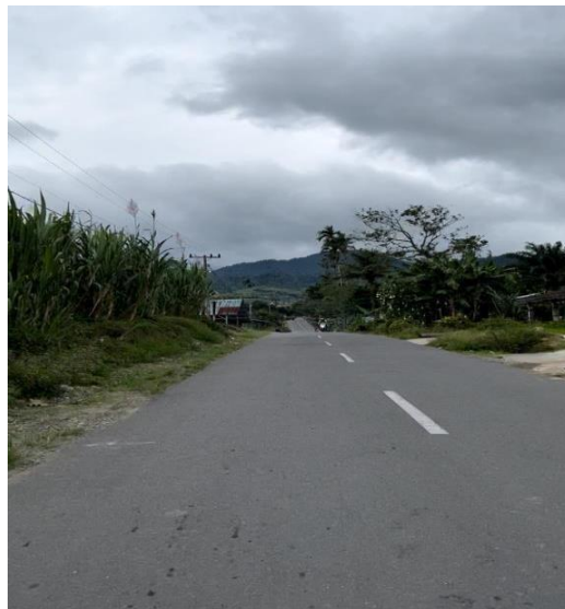
Gambar 13. Kondisi Jalan di Raja Tengah, Namuukur, Kec. Sei Bingai
