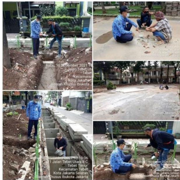
Gambar 22 Peninjauan Drainase Vertical Di Kecamatan Tebet
