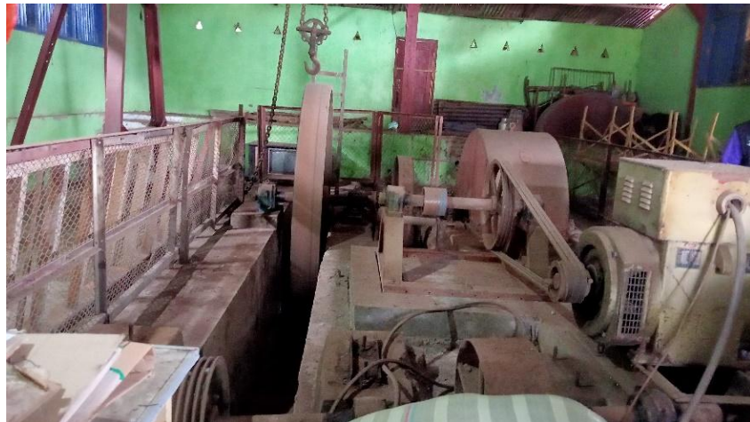
Gambar 8. Pembangkit Listrik Tenaga Air (PLTA)
