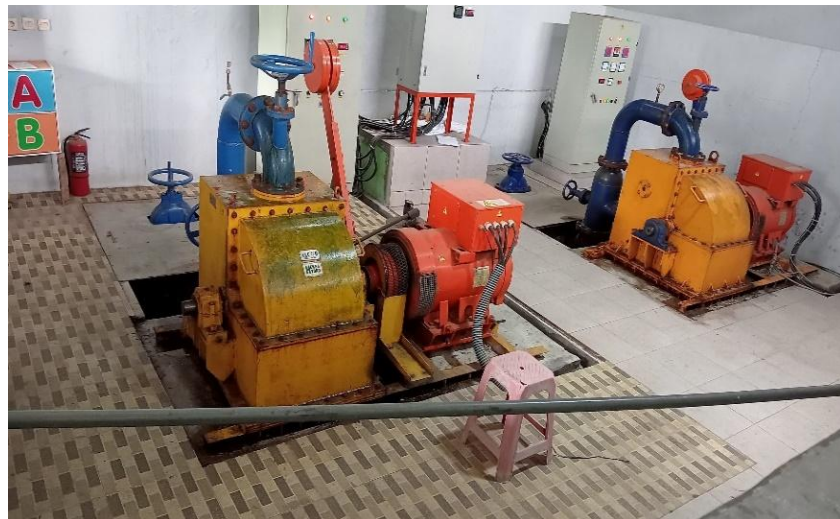
Gambar 9. Pembangkit Listrik Tenaga Mikrohidro
