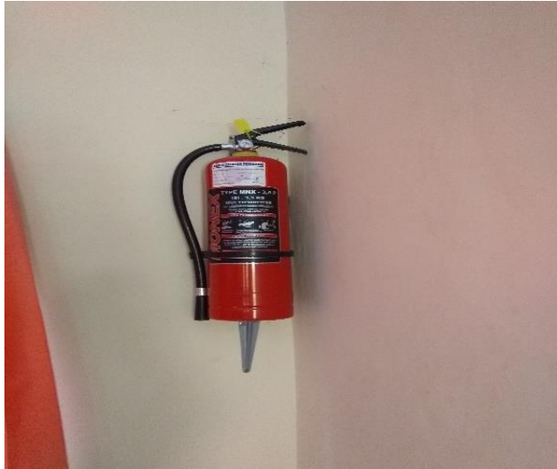
Gambar 11. Alat pemadam kebakaran
