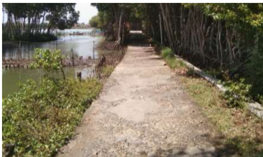
Gambar 3. Kondisi Jalan di Desa Purworejo
