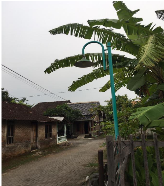
Gambar 9 Lampu Penerangan Jalan Dusun Tamanan
