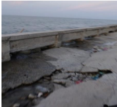
Gambar 3.28. : Kondisi jalan menuju ke lokasi rusak parah akibat abrasi pantai. 99
