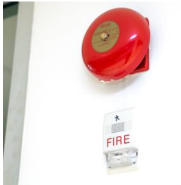
Gambar 4.5. 24 : Fire Alarm (Sumber: Maret 21, 2023. www.mabruka.co.id )
