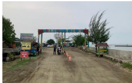
Gambar 7. Kondisi Jalan Wisata Pantai Tirang
