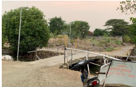
Gambar 8. Kondisi Jembatan Wisata Pantai Tirang
