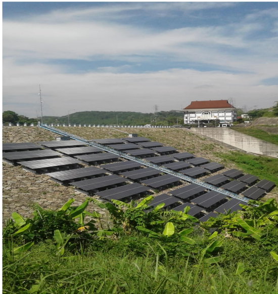
Gambar 8. PLTS Bendungan Jatibarang
