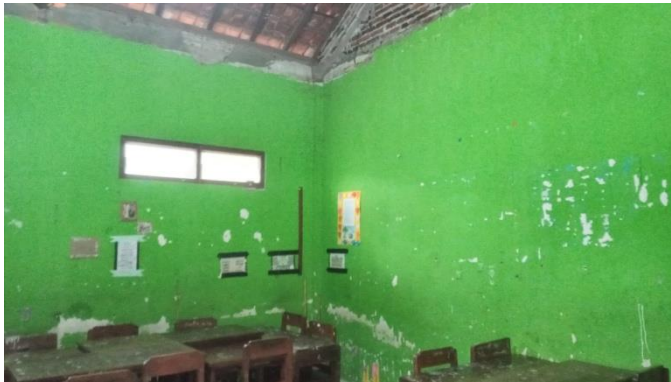
Kondisi ruang kelas sebelum perbaikan
