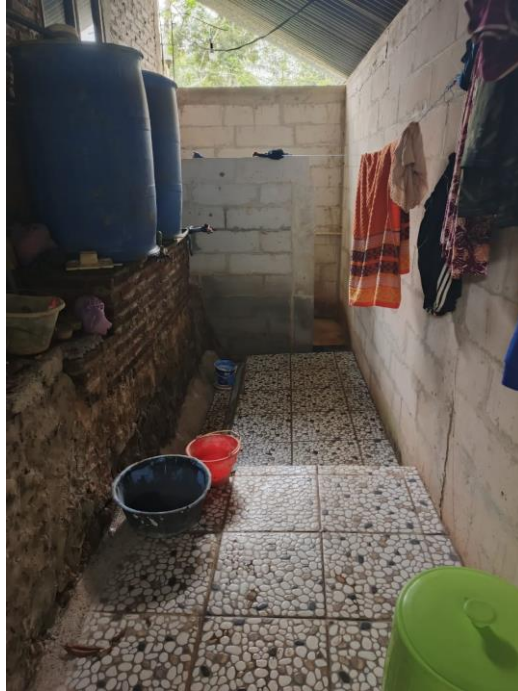
Toilet Pengunjung Air Terjun Setatah
