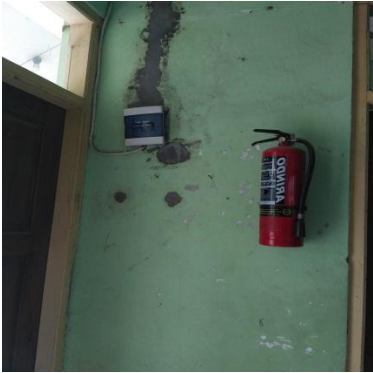
Gambar 34 Alat Pemadam Kebakaran
